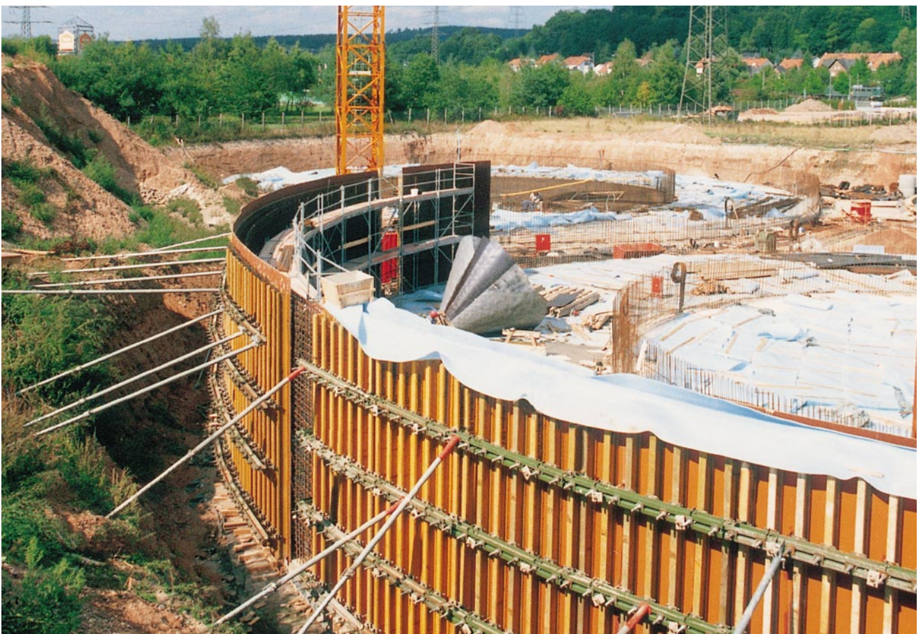
Rundbecken der Kläranlage Merzig
